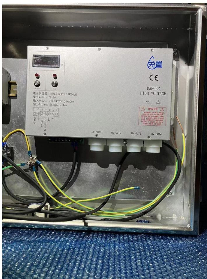
图6-1 配电箱未接高压输出接头图片
